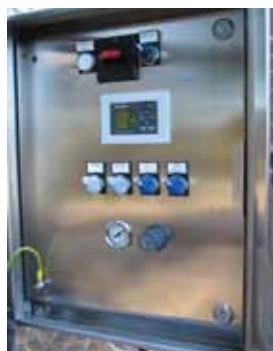
Quadro di controllo
