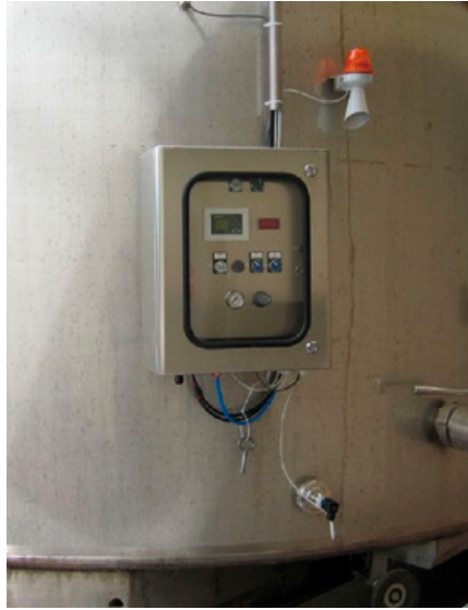
6) Instalación del cuadro de control, mediante el cual se puede controlar automáticamente la temperatura, la apertura de los bypass y la inyección de los gases técnicos (macro-oxigenación, control temporizado del CO 2 para la maceración pelicular dinámica pre-fermentativa).
